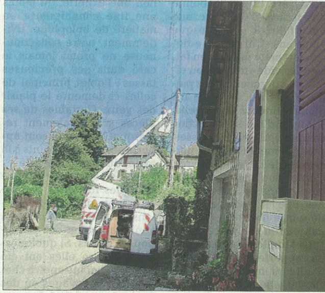
Les techniciens de France Télécom ont procédé à la pose des câbles téléphoniques sur les poteaux EDF.
